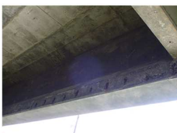
主桁：鉄筋露出
