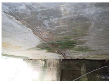
床版：遊離石灰(コンクリートジョイント)
