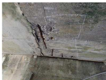
床版：鉄筋露出
