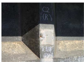
横桁：定着部の異常
