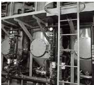
砂ろ過塔、活性炭素吸着塔
